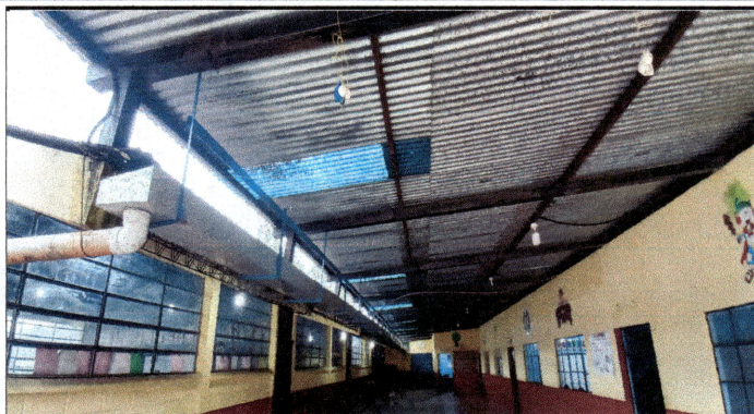
Foto1: Se observa canal nuevo instalado, con sus respectivos pescantes.
