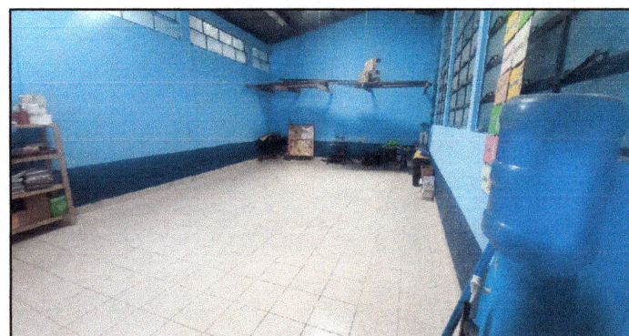
Foto 6: Aula 1 de módulo 3, Se observa piso cerámico instalado.
